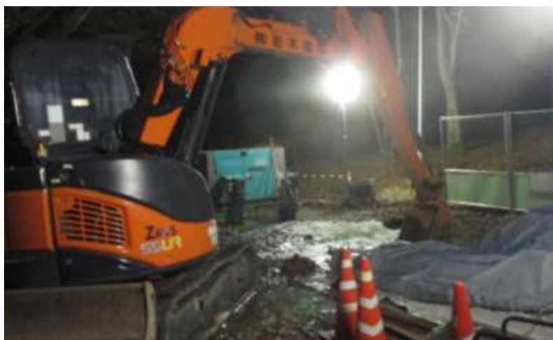
宝ヶ池公園内で漏水中の事故現場
