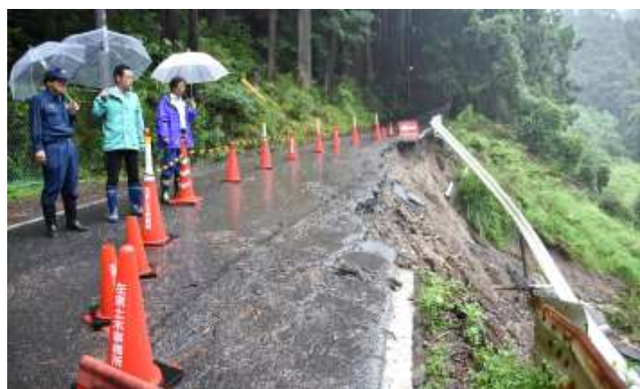
鞍馬温泉の200mほど北で道路の路肩が崩れた現場を井上参院議員・みつなが府議と調査
